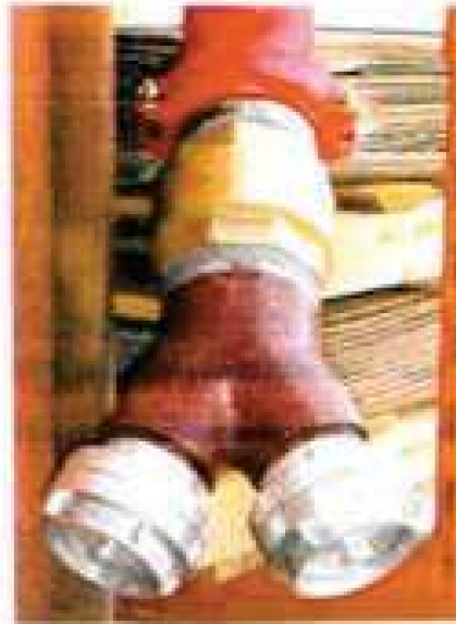
ΣΧ. 10.2.2.α Δίδυμο πυροσβεστικό υδροστόμιο, σε βιομηχανία.
