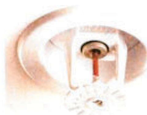
ΣΧ.10.2.3.β Καταιονητήρας τοποθετημένος στην οροφή οικοδομής. Η πυκνότητα των καταιονητήρων εξαρτάται από το είδος του κτιρίου, την ποσότητα ευφλεκτών υλικών κλπ.
