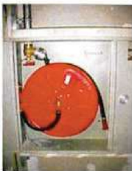
ΣΧ. 10. 2.1.6 Σε αυτή την Πυροσβεστική Φωλιά η μάνικα είναι από σκληρό σωλήνα. Πλεονεκτήματά του το ότι δεν διηλώνει κατά την κατάσβεση και μπορεί να χρησιμοποιηθεί εύκολα και από ανεκπαιδευτα άτομα.
